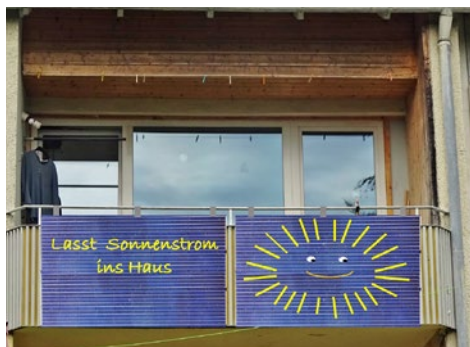
Zwei Module mit je 300 Watt (max. erlaubte Leistung) an einer Balkonbrüstung
